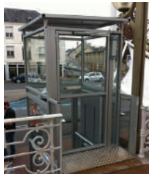
Ascenseur accès PMR
